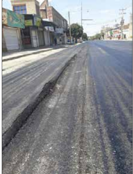
نشست زیرسازی آسفالت خیابان امام بعد از قیاریش. محمدرضا عرب‌گویینی یکی از اعضای شورای شهر با ارسال این عکس‌ها به پاسارگاد عنوان کرد بر خلاف اظهار نظرهای مسوولان شهرداری یک کامیون با بار کمتر از ۱۰ تن روی کفلال حرکت کرد و کفلال نشست کرد.
